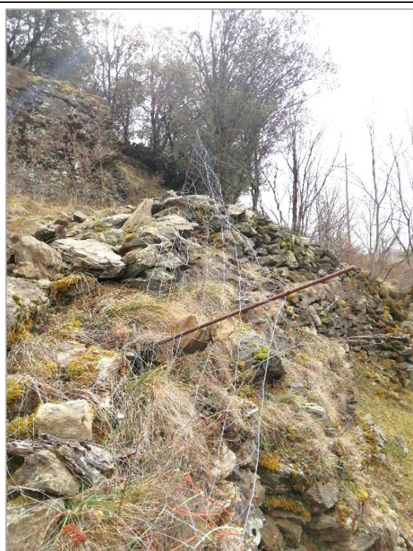
Tancat en mal estat.
